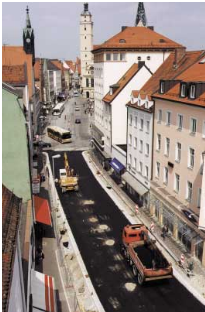
Der Umbau der Donaustraße geht zügig voran - im Spätherbst soll die Einfallstraße zur Altstadt wieder befahrbar sein. Die starke Einschränkung der Bedienungsqualität der INVG hat dann ein Ende. Infolge der täglichen Verspätungen wegen der Sperrung der Donaustraße ist derzeit auf einigen Linien ein spürbarer Rückgang der Busbenutzer festzustellen.
